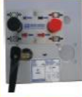
Kontrol Paneli (Fren - Hava Süspansiyonu) Hava Tesisatı : İthal hortumlar ve rekorlar (Wabco - Knorr) Yük ayar ventili, Seviye ventili, Süspansiyon körük ventili Basınç regülatör valfi, Rampa kolu (Wabco - Knorr)
